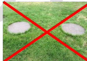
NON CONFORME – COUVERCLES DE BÉTON NON DÉGAGÉS ( LA VIDANGE NE SERA PAS EFFECTUÉE! )
